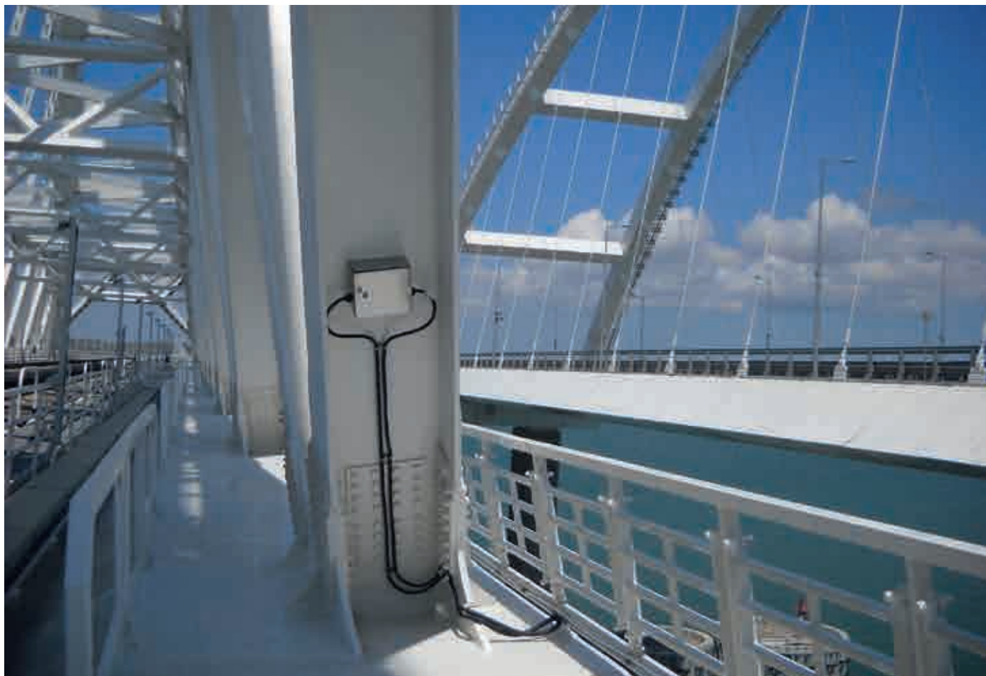
Шкаф СМИС с аналого-цифровым преобразователем, смонтированный на арке железнодорожного моста транспортного перехода через Керченский пролив
