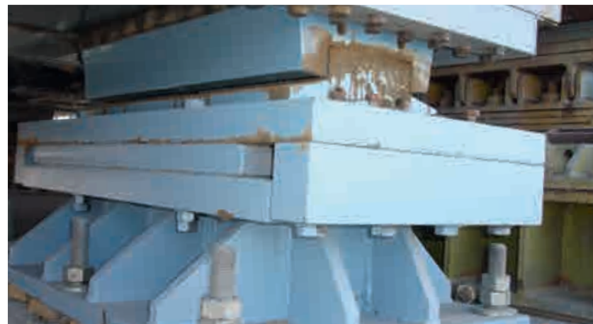
Сейсмостойкая опорная часть на мосту в Туркмении
